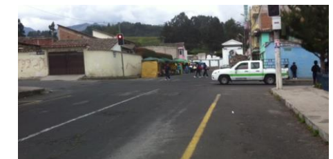
Intersección Semaforizada Bolívar y Juan Montalvo. Déficit señalización horizontal.
